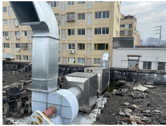
印刷废气处理设施
