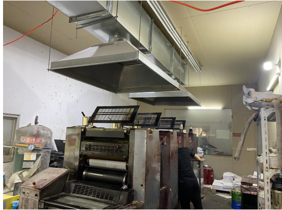
印刷废气收集设施
